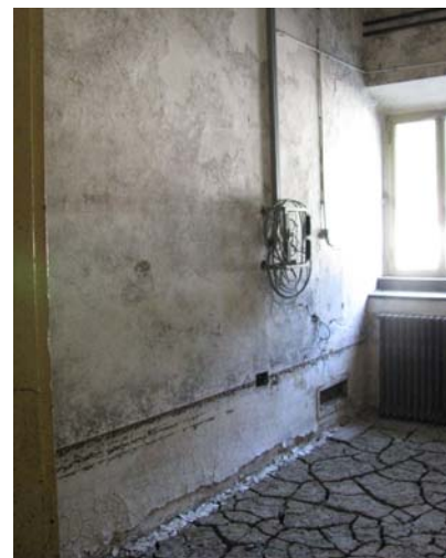
Ugovizza: la stanza dove c'era il centralino. Sul pavimento si nota il deposito di fango portato dall'alluvione del 2003, oltre mezzo metro di spessore.
